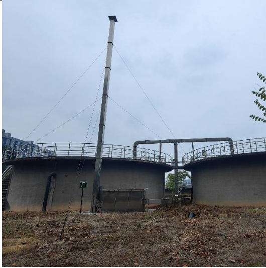
现有二期污泥浓缩池及臭气处理系统
