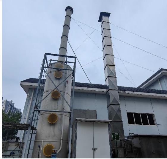
现有二期污泥脱水间及臭气处理系统
